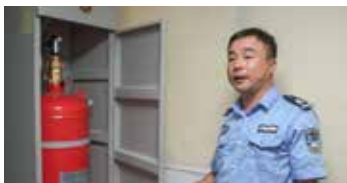
王亮队长现场讲解七氟丙烷气体灭火装置
